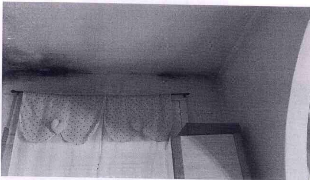
Infiltrazioni e muffa nella cucina dell'abitazione al lotto 2 p.lla 307 sub 5
