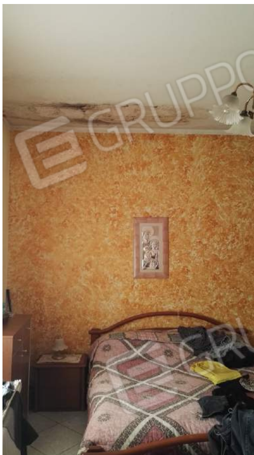
La camera da letto con infiltrazioni e muffa, dell'abitazione al lotto 2 p.lla 307 sub 5
