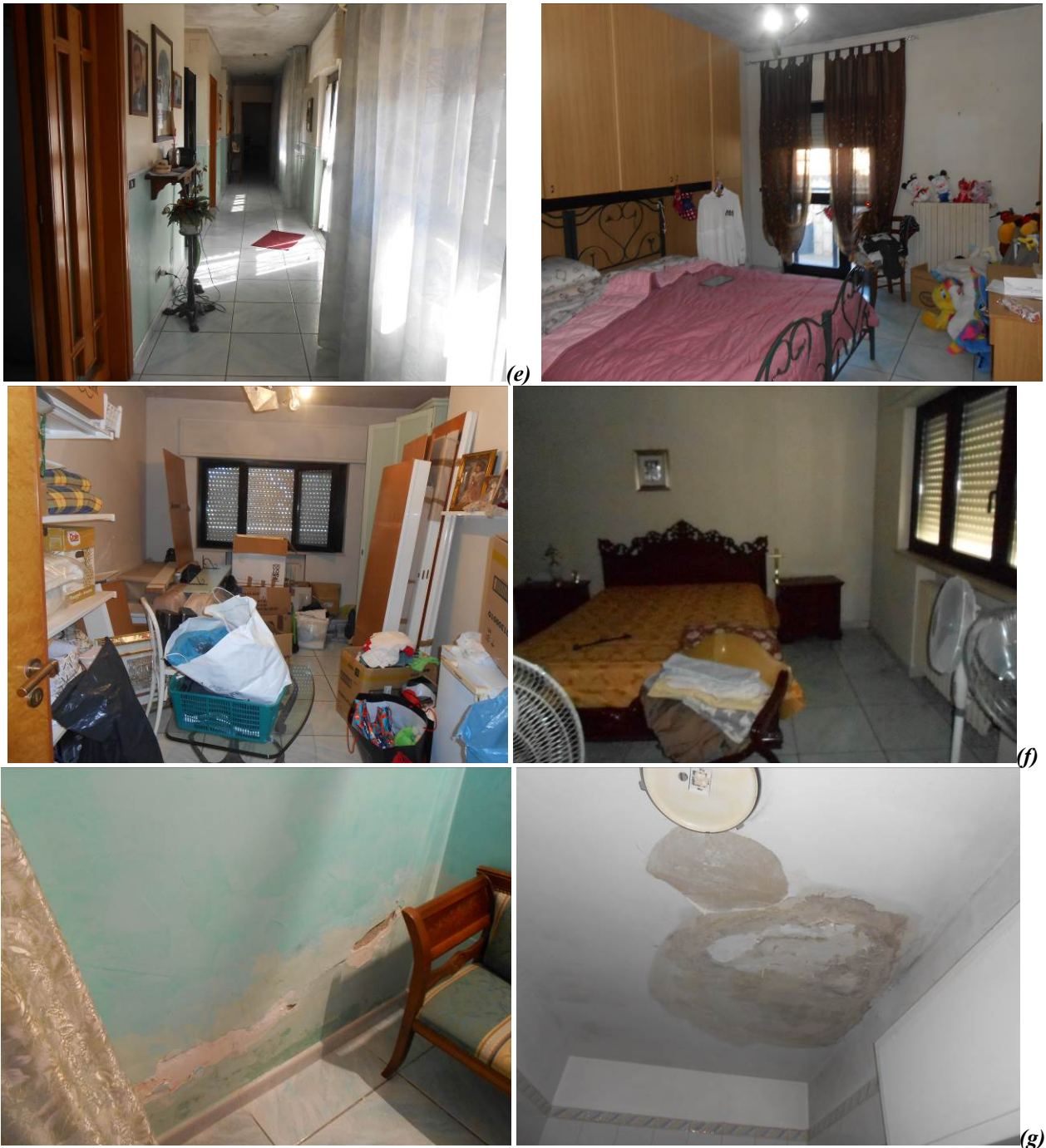
Figura n° 7. Fotografie dell'abitazione a piano rialzato: salotto (a); cucina (b); ripostiglio (c); bagni (d); corridoio (e); camere (f); rivestimenti danneggiati da fenomeni di umidità (g).
