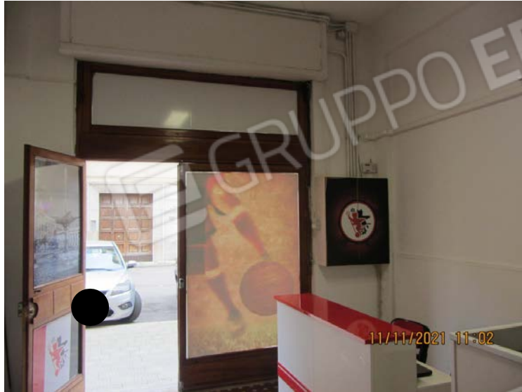
FOTO N° 76: VISTA INTERNA DELLA PORTA D'INGRESSO E DEL MISURATORE ELETTRICO DA CUI HA ORIGINE LA LINEA ELETTRICA A VISTA IN CANALINE.
