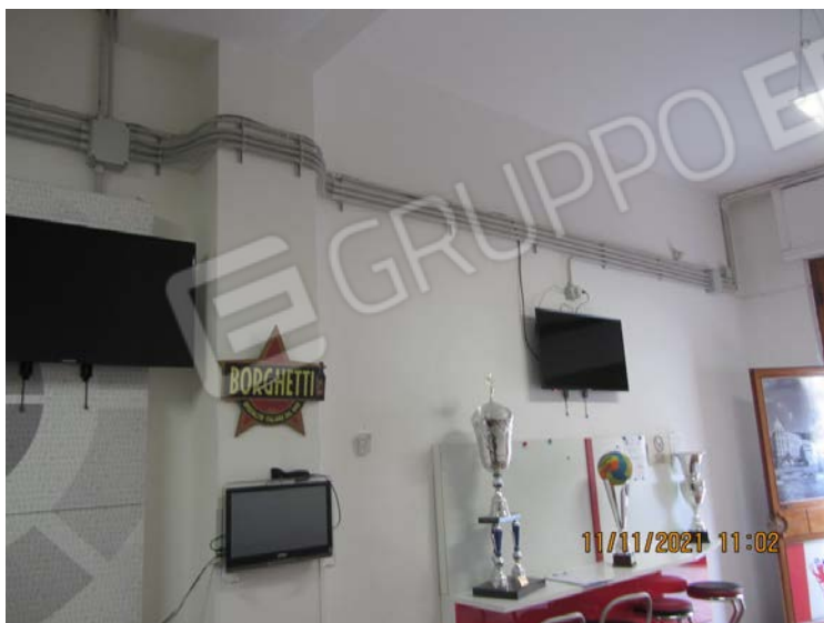
FOTO N° 78: VISTA GENERALE DELLA LINEA ELETTRICA A VISTA RILEVATA AL SUO INTERNO REALIZZATA DALL’AFFITTUARIO.
