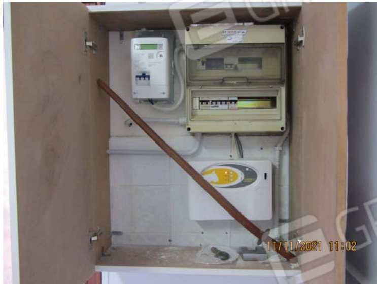
FOTO N° 77: VISTA PARTICOLAREGGIATA DEL MISURATORE ELETTRICO E DEL QUADRO DEGLI INTERRUPTORI DIFFERENZIALE.
