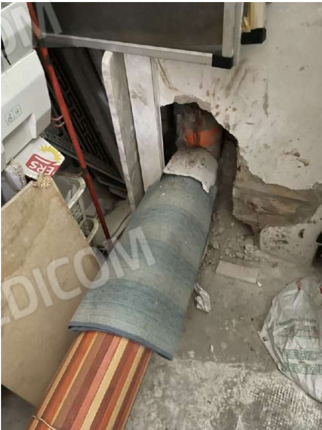
Figura 15. LOTTO UNICO: Immobile pignorato al F. 30, P.IIa 260, Sub. 16 ubicato in San Severo alla Via Giulio Cesare n. A/18 (tubazione condominiale che attraversa la cantina).
