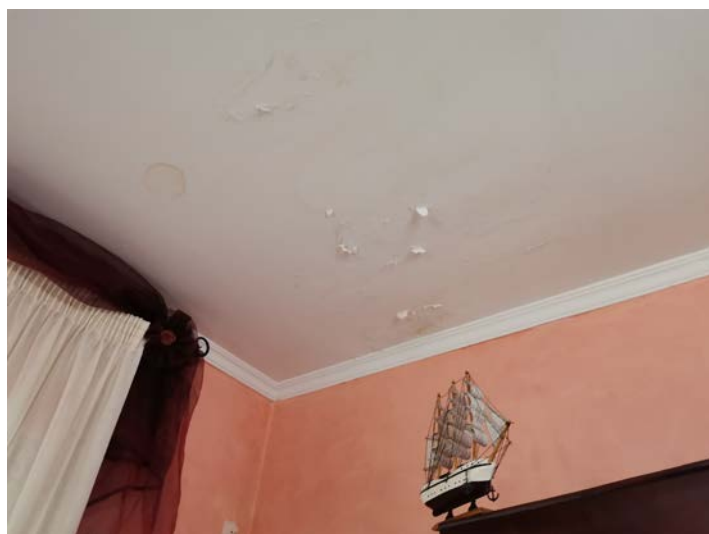
Infiltrazioni nel soggiorno
