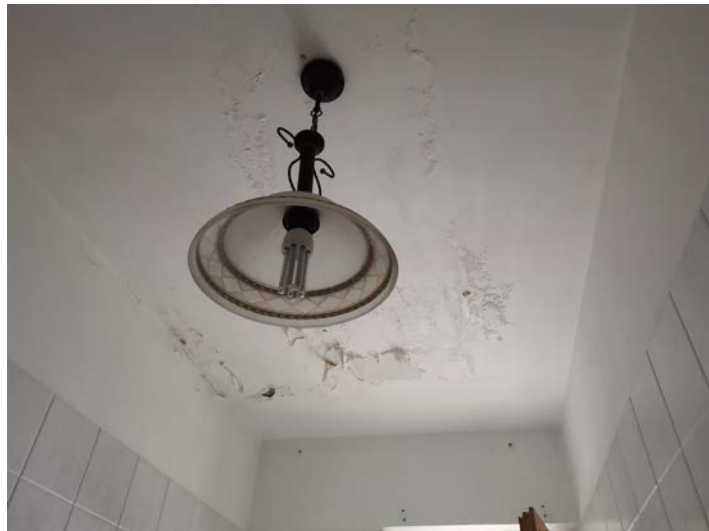
Le infiltrazioni nel bagno
