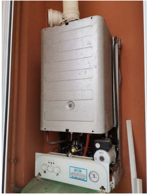
La caldaia non funzionante
