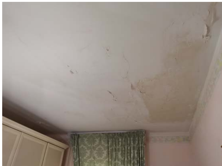
Le infiltrazioni nella cameretta
