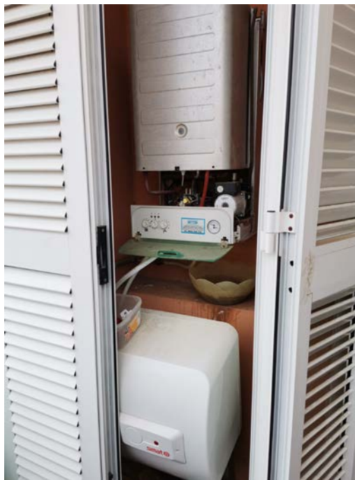
Lo scaldabagno posto sotto la caldaia
