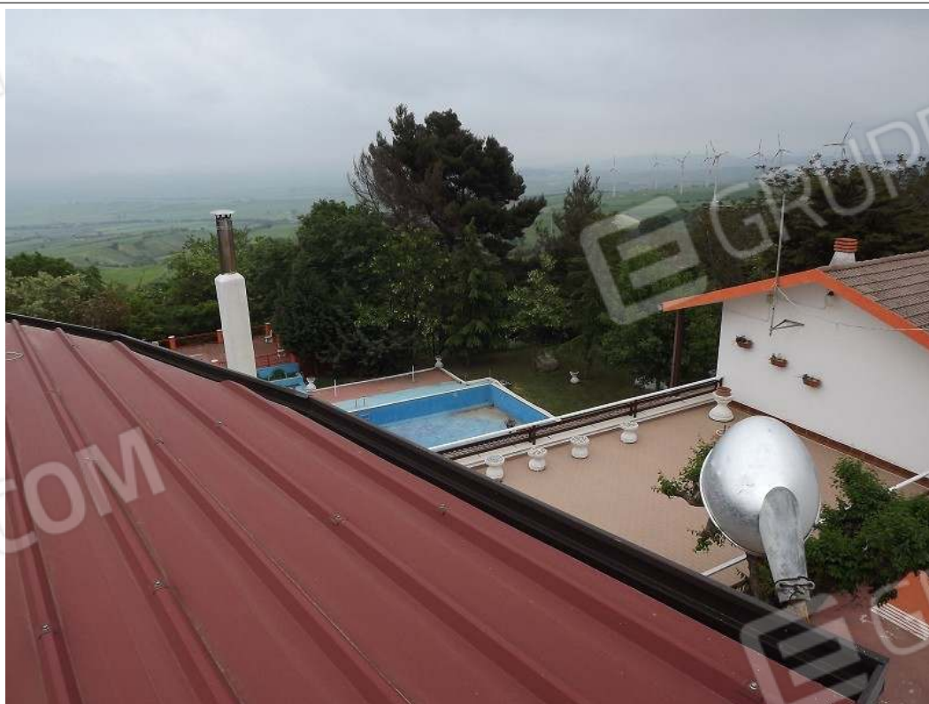
Copertura abusiva in pannelli accoppiati di colore rosso posta sulla sala ricev.
