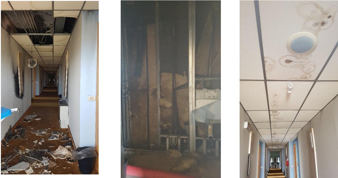
Figura 30 – Esempi di danneggiamento al secondo piano
