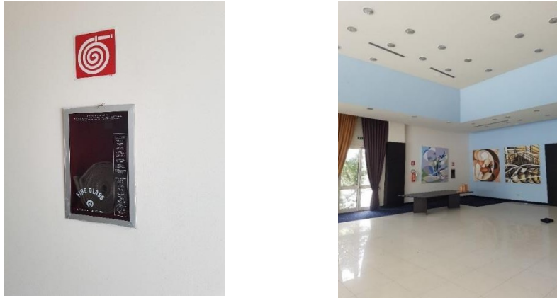
Figura 21 – Estintori e idranti dislocati nell'albergo
