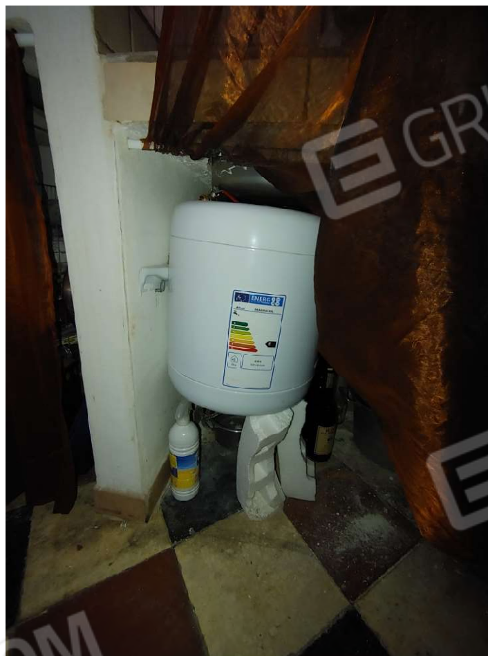
Foto C22 - LOTTO 1 - SCALDACQUA ELETTRICO
