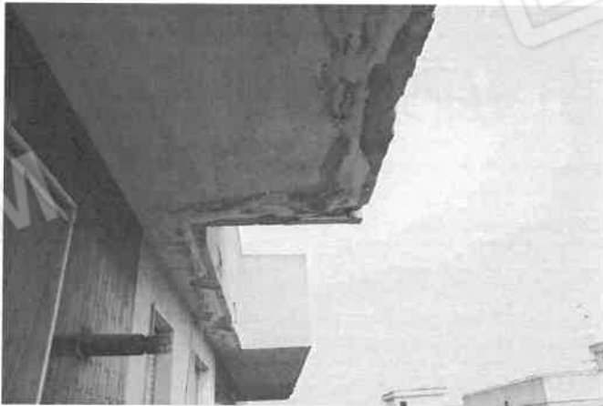
Foto n°8 Intradosso del cornicione del palazzo visto dal balcone dell'esecutato
