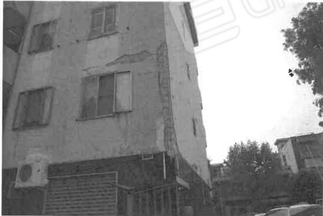
Foto n°7 Cadute di intonaco dalle pareti esterne dell'edificio
