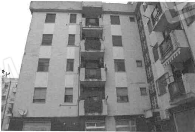
Foto n°5 Sofferenze negli intonaci di facciata
