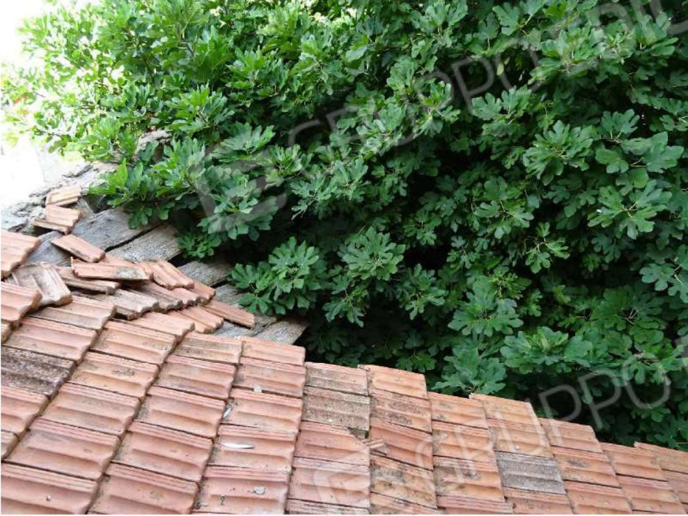
Foto n. 17 Particolare copertura con tetto crollato
