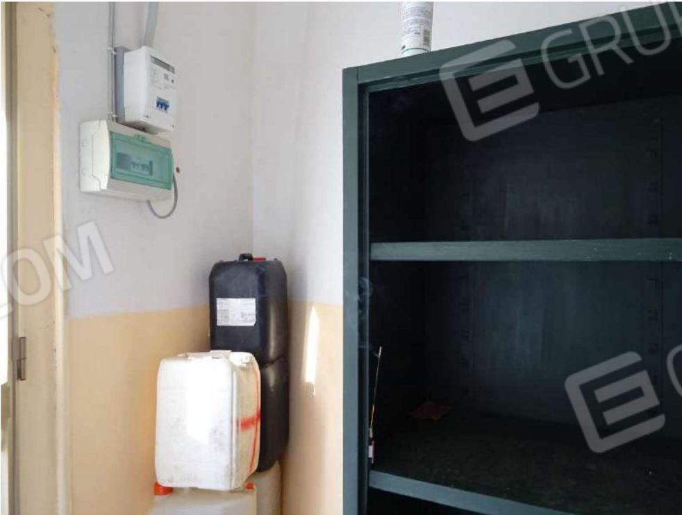
Foto n. 12 Zona ingresso - impianto elettrico
