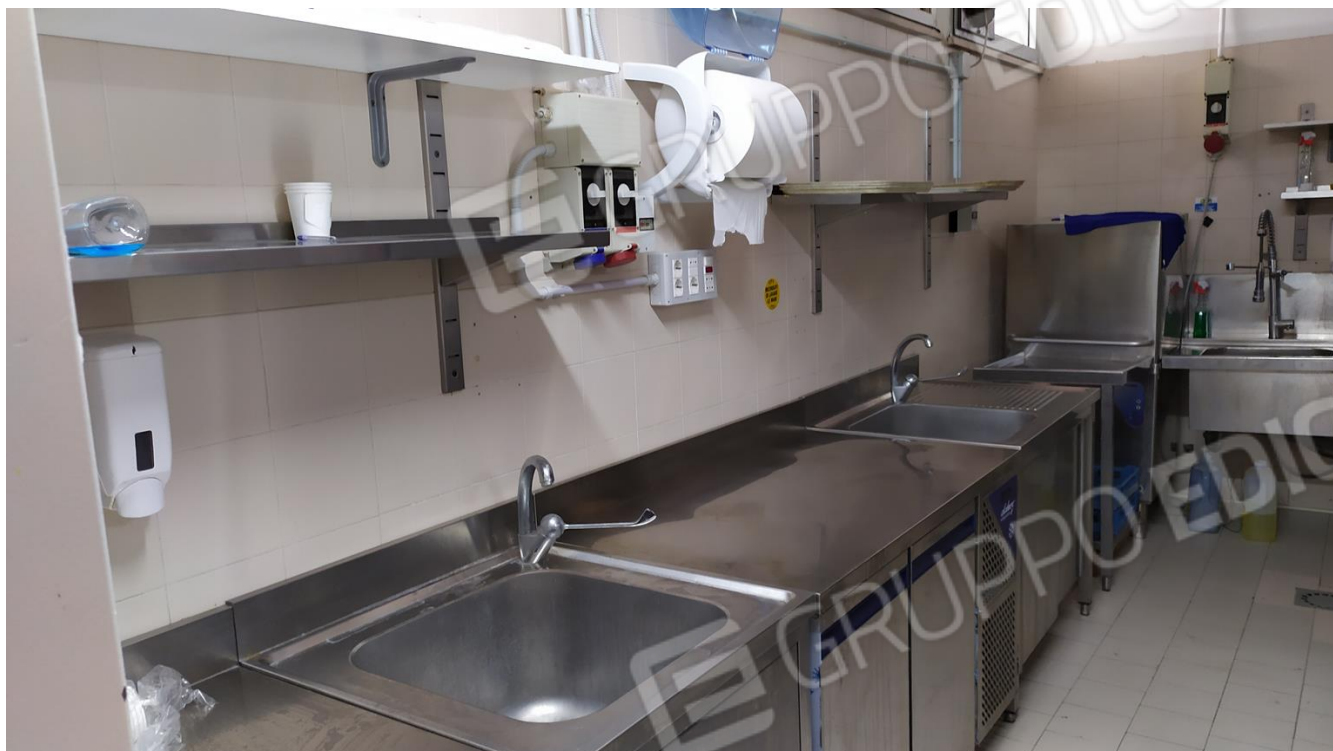
FOTO I.29: in evidenza, la cucina con i suoi impianti ed attrezzature varie.
