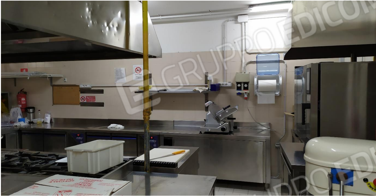
FOTO I.31: in evidenza, la cucina con i suoi impianti ed attrezzature varie.
