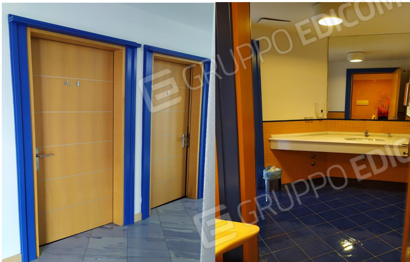
FOTO I.45-46: in evidenza, a sx le porte di accesso ai bagni ospiti, a dx il bagno ospiti donne e portatori H.
