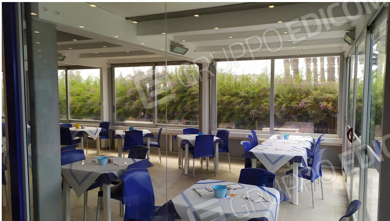
FOTO I.25: in evidenza, l'ampliamento della sala ristoro realizzato senza titolo edilizio, insanabile, da rimuovere/demolire.
