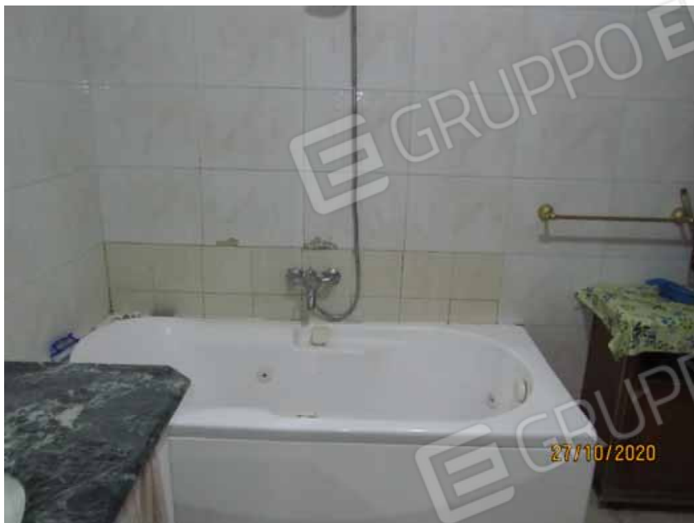
FOTO 9 – Bagno (particolare rappezzo mattonelle nella zona vasca da bagno).
