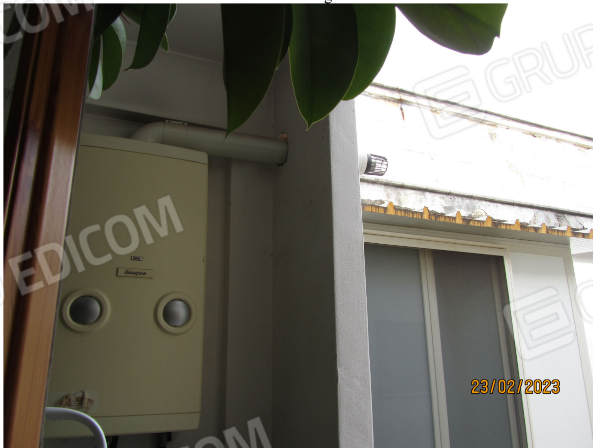
FOTO N.10 – Posizione della caldaia alimentata a gas metano.
