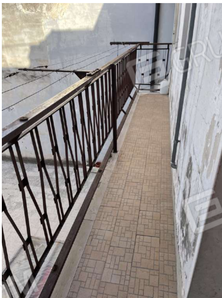
Figura 11. LOTTO UNICO: Immobile pignorato al F. 31, P.IIa 6584, Sub. 25 ubicato in San Severo alla Via Varano n. 65 (balcone prospiciente il terrazzo a livello del primo piano).
