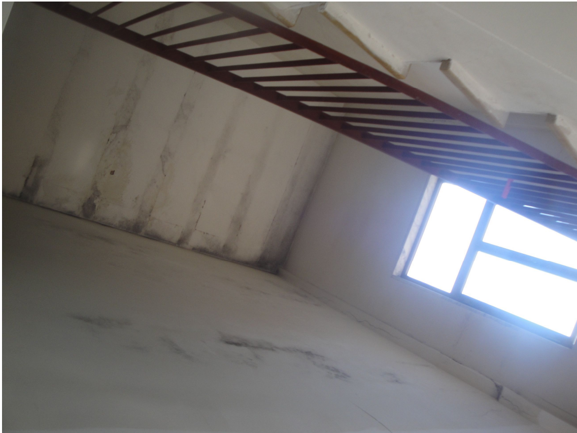
Foto 11: Abitato del Comune di Margherita di Savoia. Fabbricato sito alla Via Togliatti n. 5 (in cui si inserisce, al piano terzo, l'appartamento costituente il lotto 1). Interno del vano scala.
