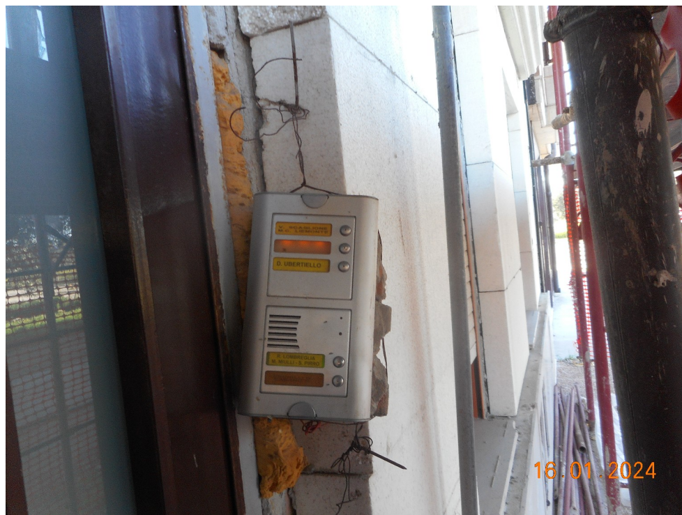
Foto 2: Citofono di Via Stornara 19.
