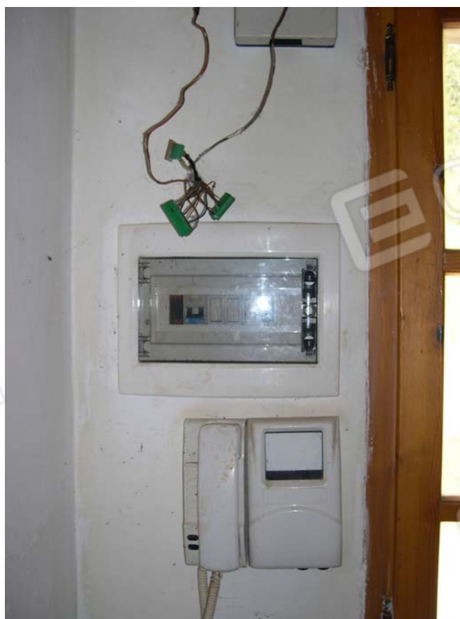
Figura n. 28 – impianto elettrico del u.i. al piano rialzato.
