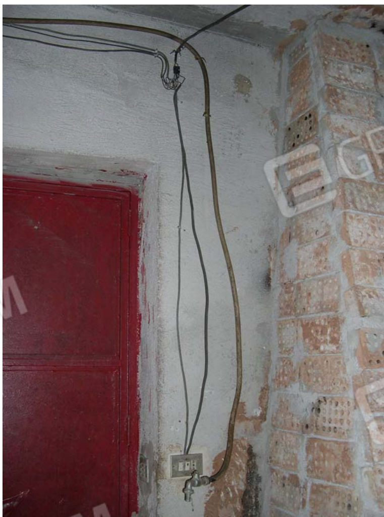
Figura n. 22 – impianto elettrico con cavi a vista
