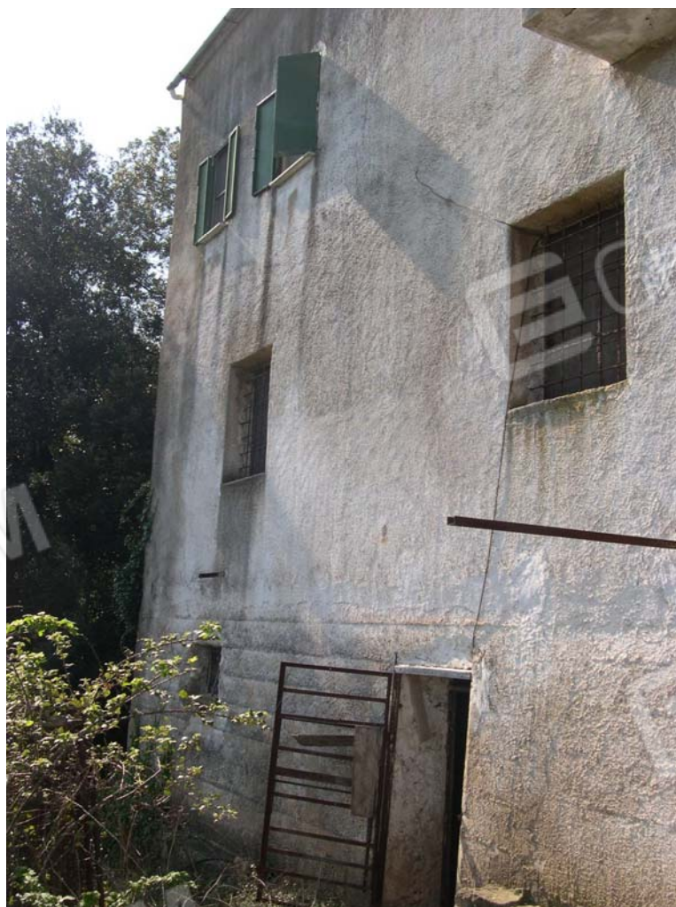
Foto n. 12 – Muratura nella parte inferiore in cemento armato.
