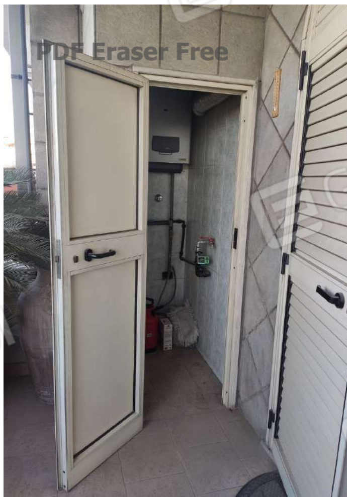
Foto 26 - Caldaia ubicata su balcone
