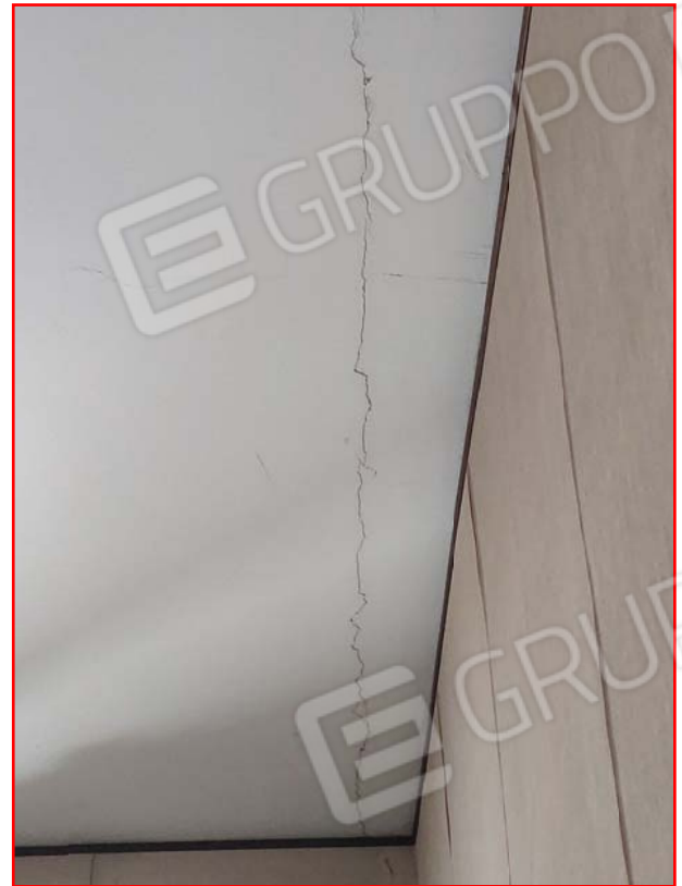
Foto 9 - Lesioni sui solai da verificare con prove in situ
