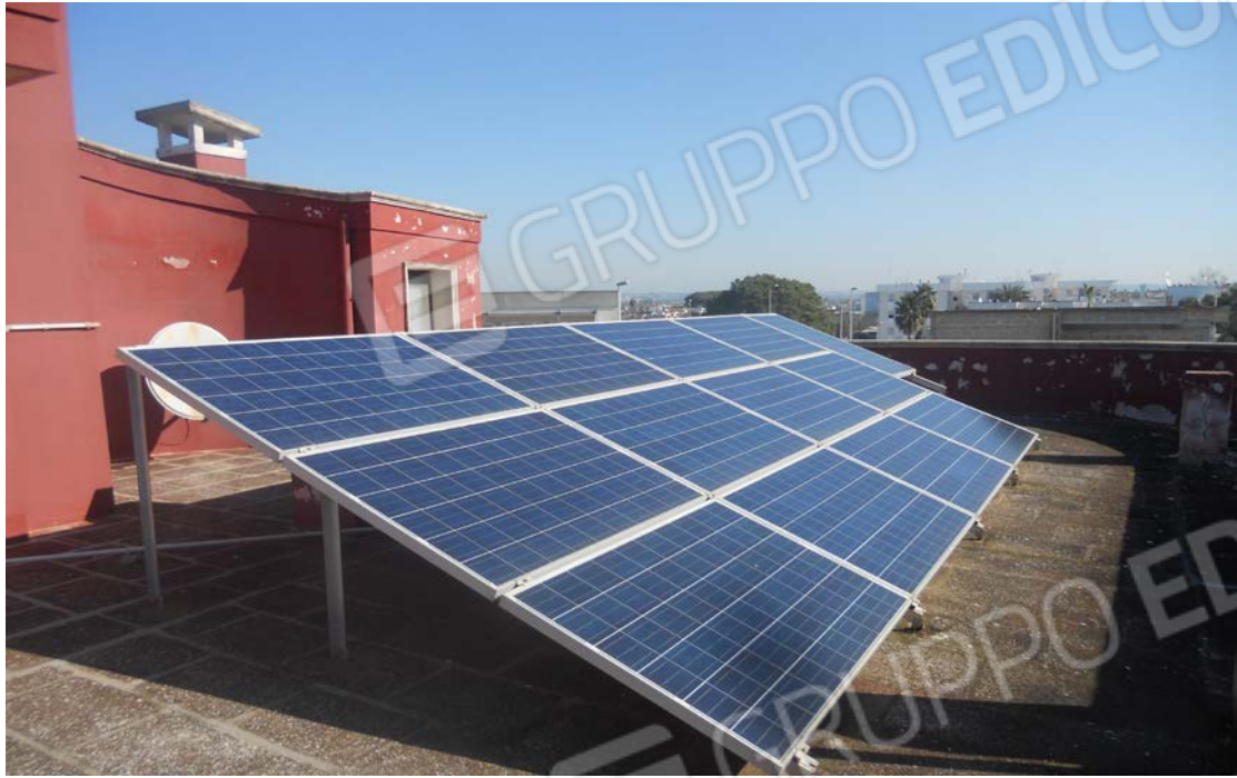
FOTO N.10 PARTOLARE IMPIANTO FOTOVOLTAICO
