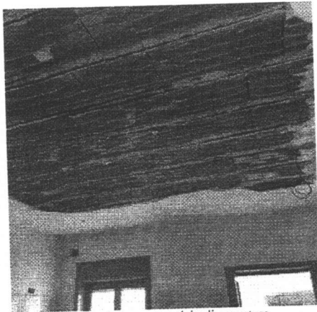
Sfondellamento solaio di copertura
