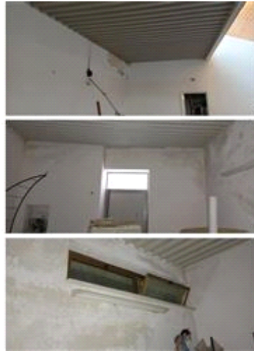
Tracce di infiltrazioni
