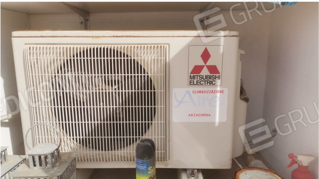
FIGURE 29: UNITÀ ESTERNA CONDIZIONAMENTO
