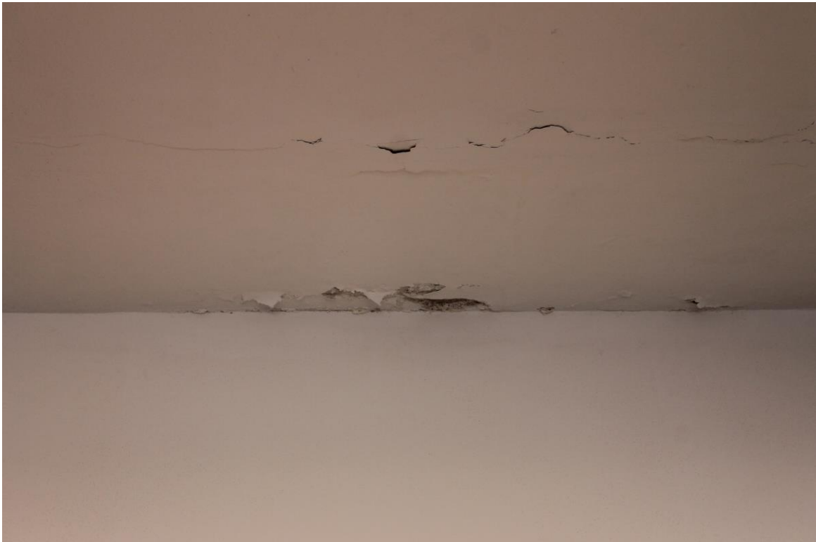
Particolare dei danni provocati dalle infiltrazioni
