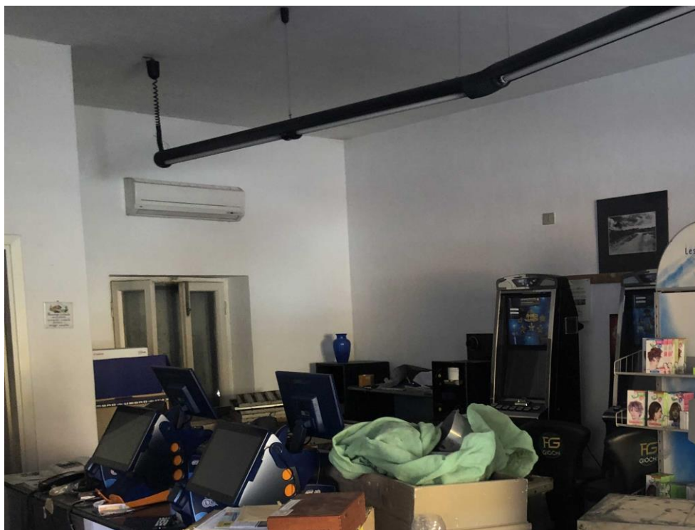
Particolare dello split
