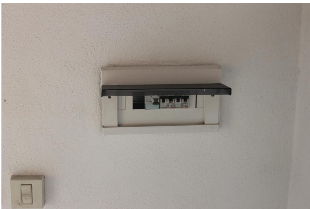
Particolare del quadro elettrico del locale
