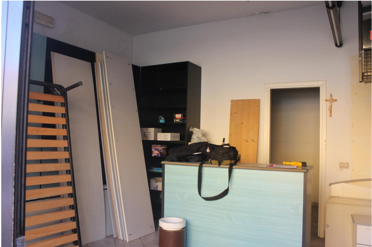
Foto interna del locale commerciale in alto si può notare il distacco della pittura
