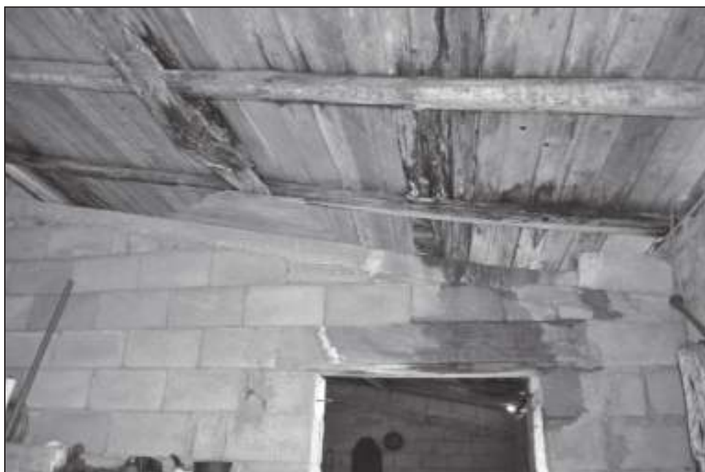
Figg.45-46-47. Dettagli del degrado degli elementi strutturali della copertura
