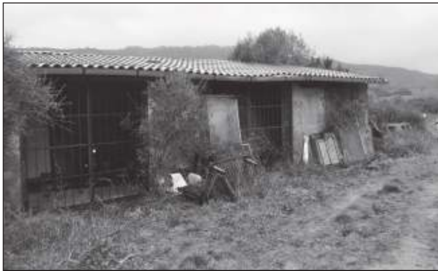
Fig.52. Vista esterna- deformazione della falda a seguito del cedimento dell'orditura lignea
