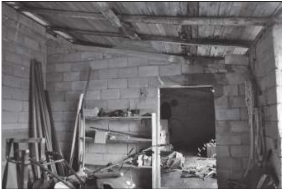
Figg.42-43-44. Interni del vano deposito e dettaglio della copertura con rilevante cedimento
