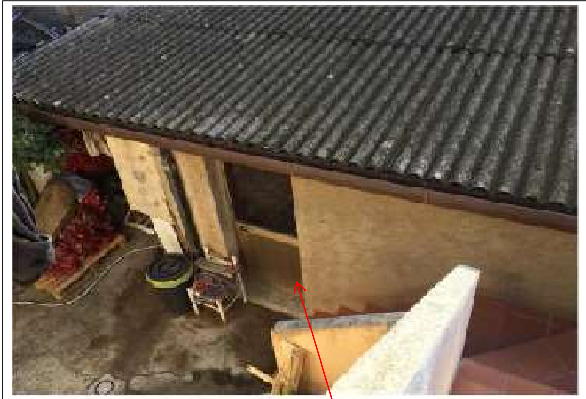
Foto n. 5 - Immobile abusivo nella corte
