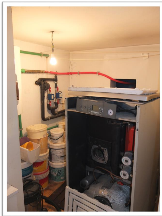
Locale Centrale Termica piano interrato
