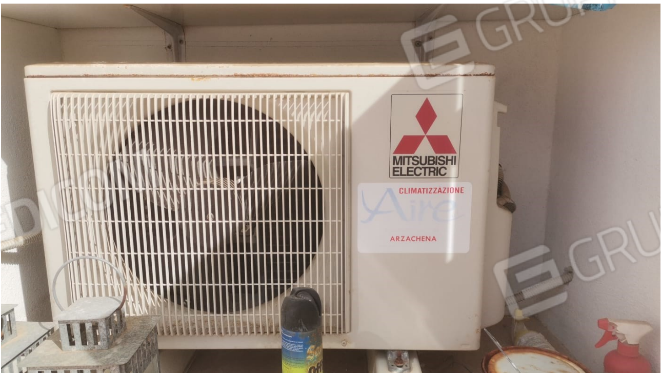
FIGURE 29: UNITÀ ESTERNA CONDIZIONAMENTO
