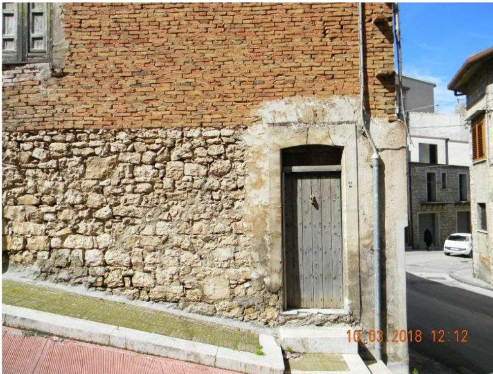
Foto 31 - Portone di ingresso al civ. n.2 della Via Berta. Essendo stata demolita la scala di accesso al piano soprastante a partire da tale ingresso, ad oggi tale apertura conduce soltanto ad un piccolo vano, pure incluso nella vendita, segnato in rosso nella planimetria catastale che segue, relativa al sub.14 della particella 1464 non oggetto, invece, della
