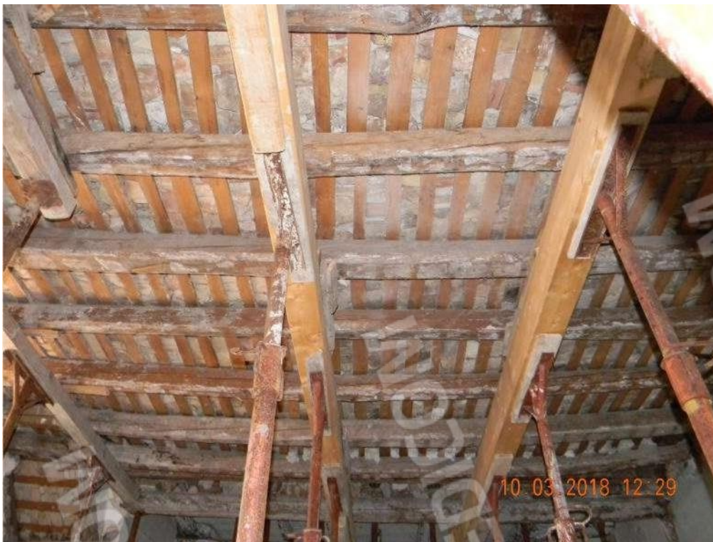
Foto 12 - Soffitto ligneo soprastante parte del vano
