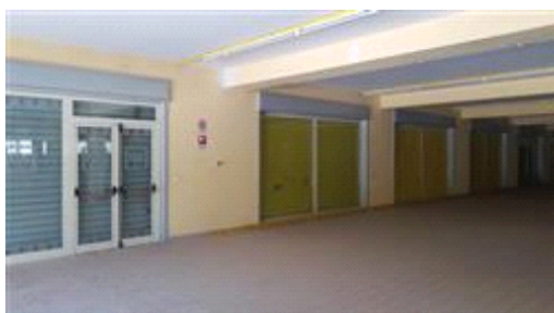
infissi in alluminio taglio termico e cassone con avvolgibile in materiale metallico
