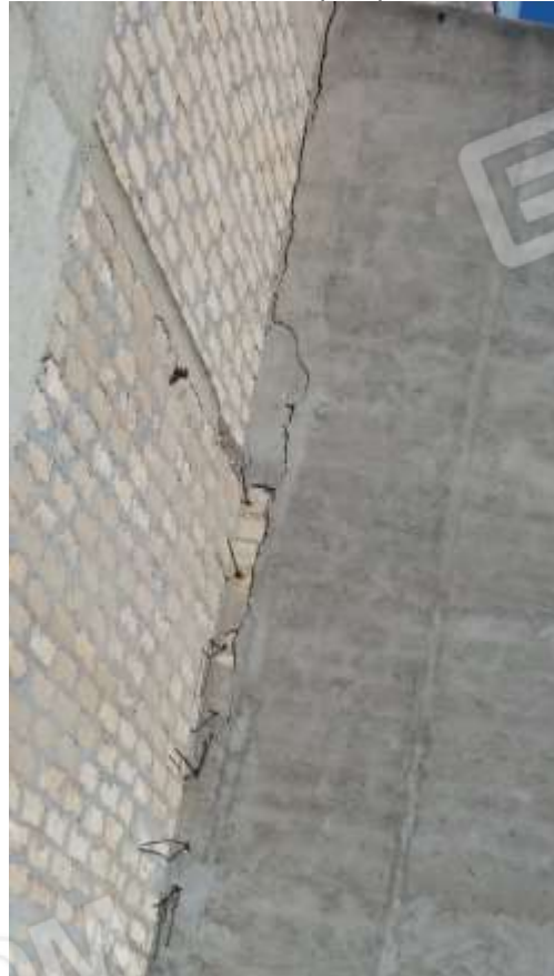
FOTO 4 - Particolare della lesione
