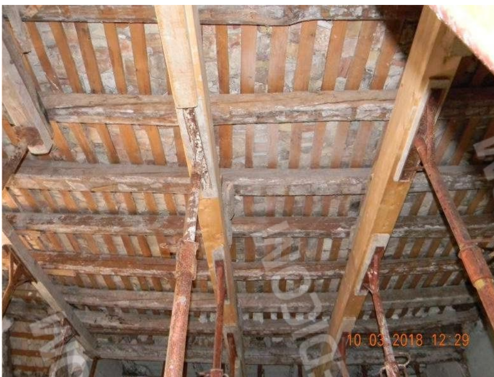
Foto 12 - Soffitto ligneo soprastante parte del vano
