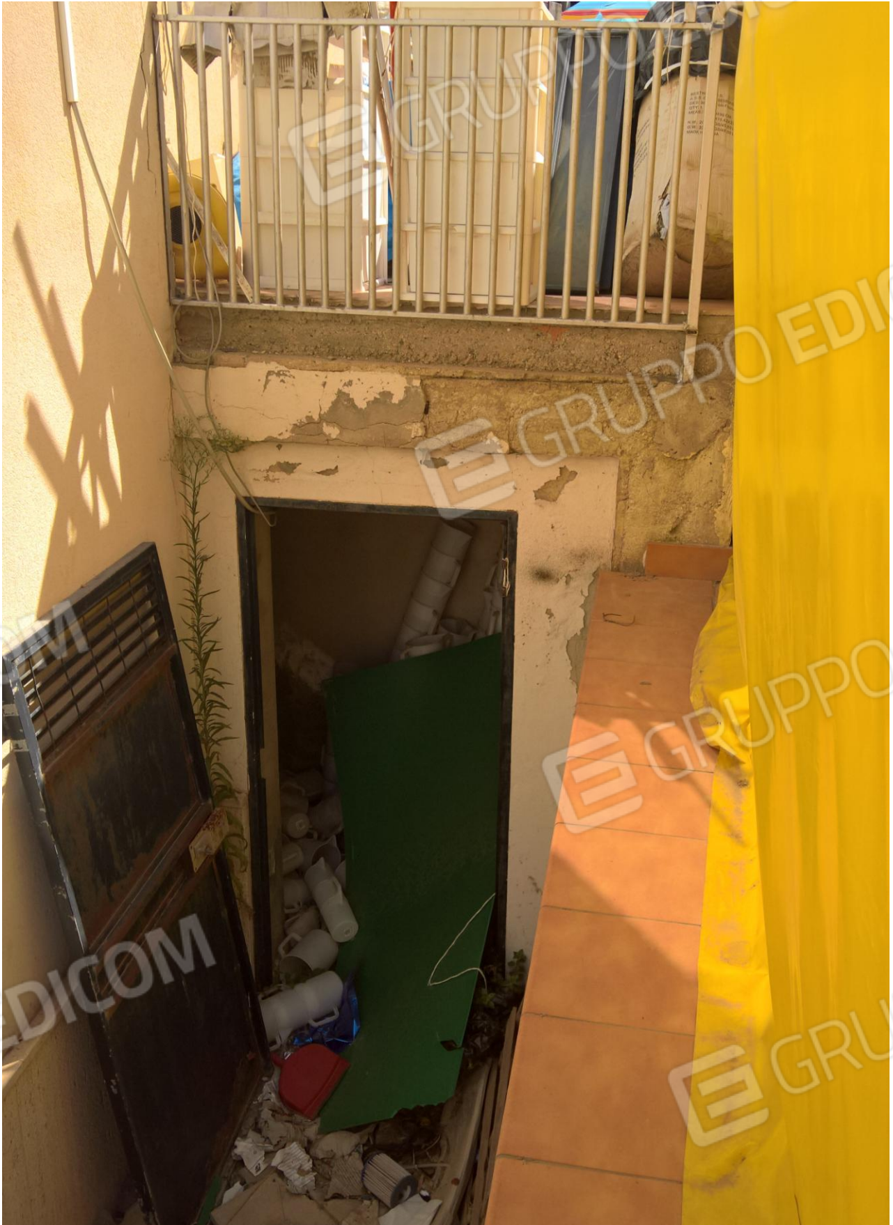
Foto 19 – Esterno: corte annessa – locale tecnico sotto alla parte di terrazzamento abusivo (abuso da dover demolire e ripristinare allo stato originario)
