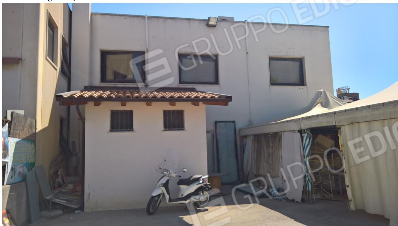
Foto 22 – Esterno: corte annessa non terrazzata (abuso locali WC da demolire e ripristinare allo stato originario)
