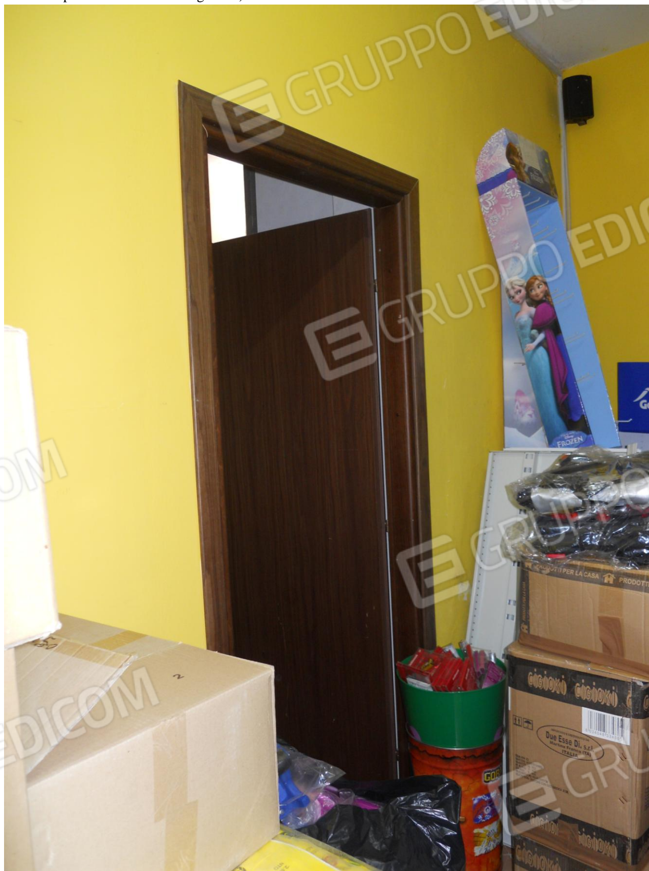
Foto 9 – Interno negozio - magazzino posteriore: porta di accesso ai locali WC (Abusi edilizi da demolire e ripristinare allo stato originario)
