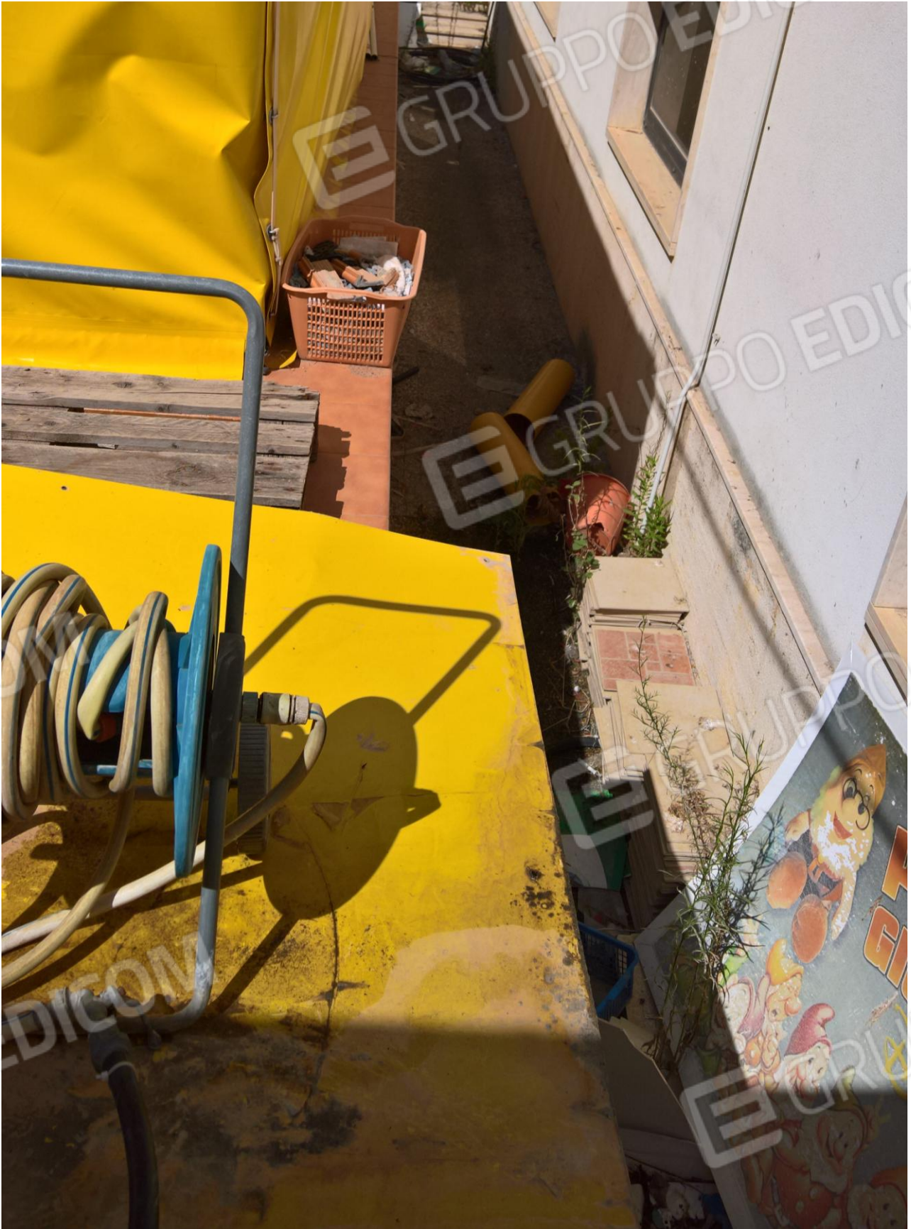
Foto 20 – Esterno: corte annessa – locale tecnico sotto alla parte di terrazzamento abusivo (abuso da dover demolire e ripristinare allo stato originario)
