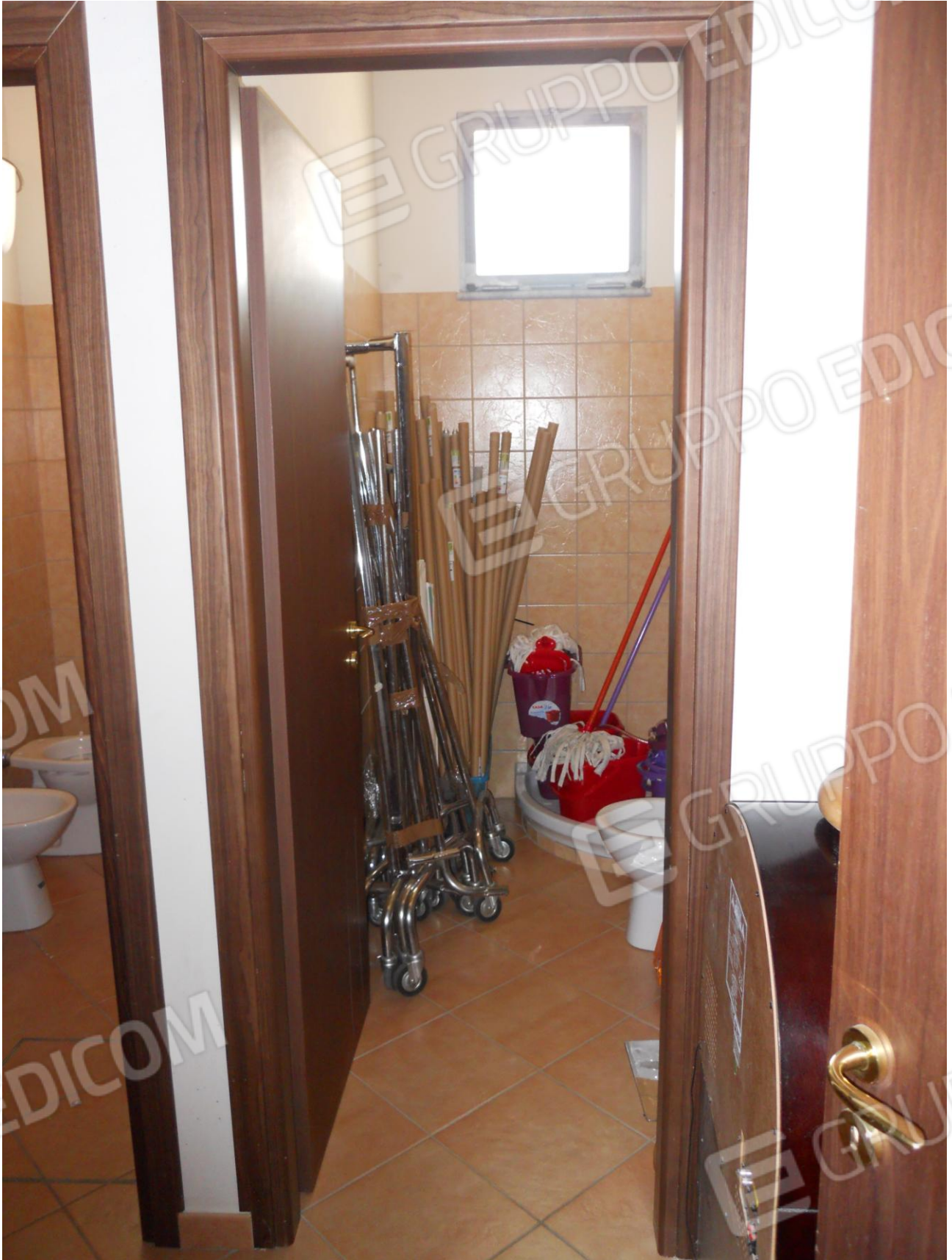
Foto 10 – Locali WC (Abusi edilizi da demolire e ripristinare allo stato originario)
