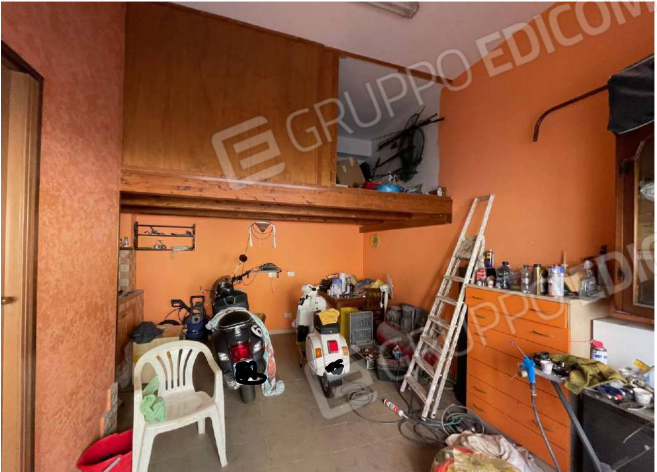
Foto 14 – Interno box con parziale soppalco abusivo insanabile.
