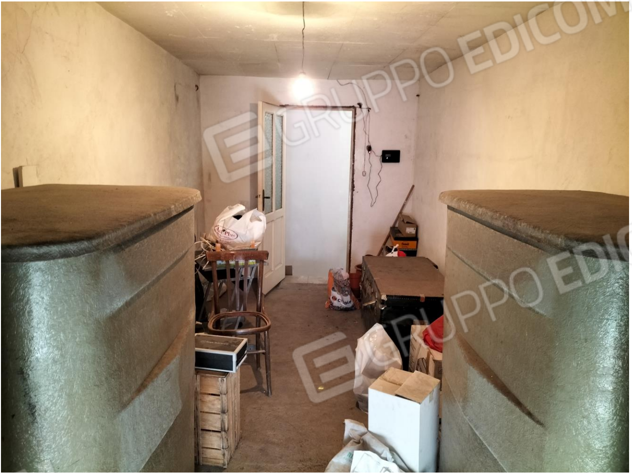
Riserva idrica al piano ammezzato.
