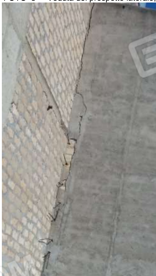
FOTO 4 - Particolare della lesione
