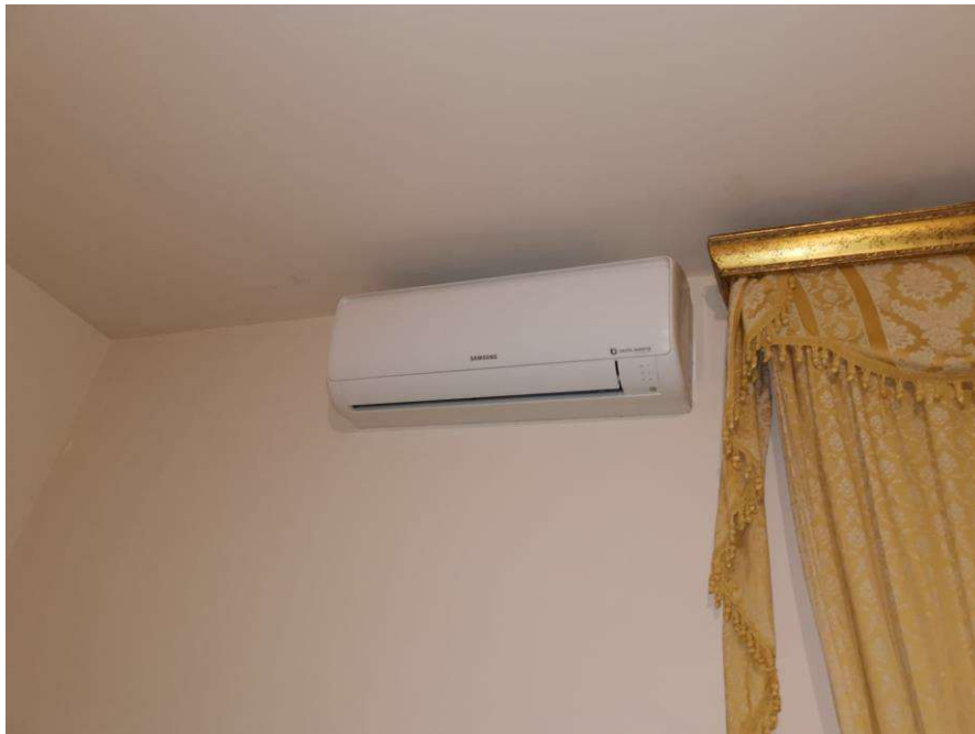
foto n° 19 climatizzatore camera da letto
