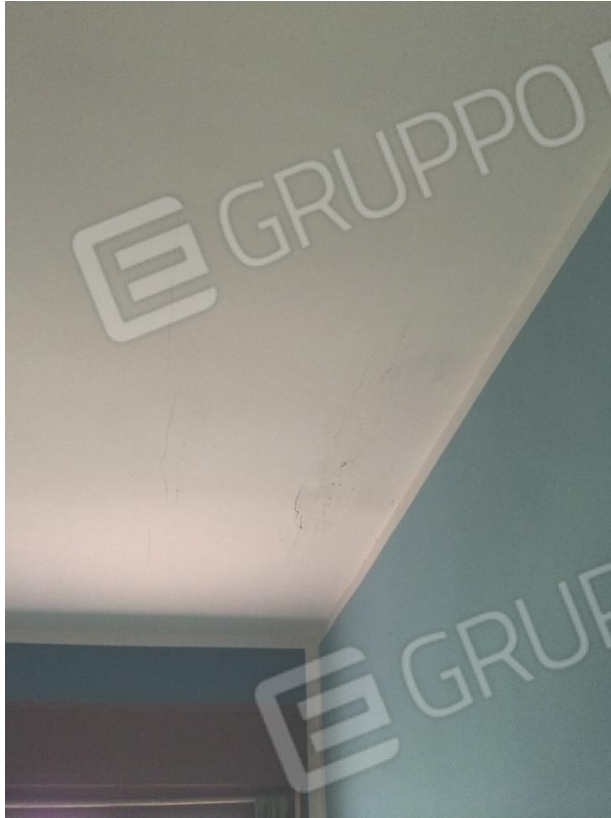
Lesioni sul soffitto della camera n. 1
