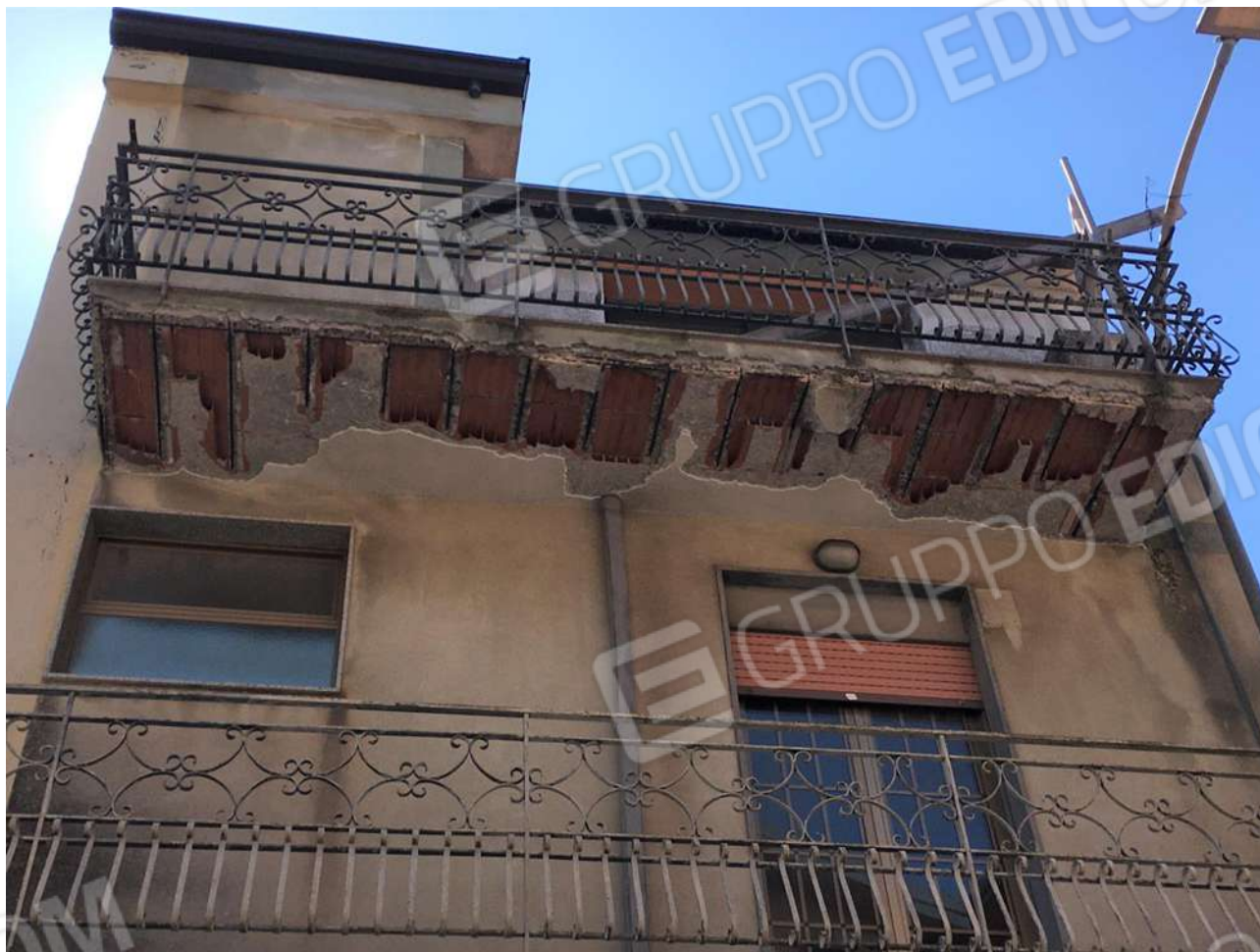
FO-32 danni da infiltrazioni idriche al sottoballatoio del piano secondo
