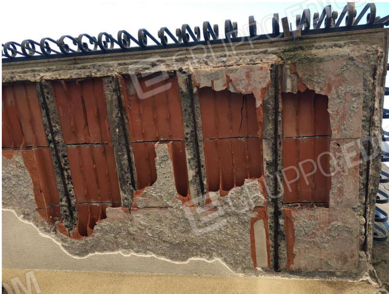
FO-34 danni da infiltrazioni idriche al sottoballatoio del piano secondo
