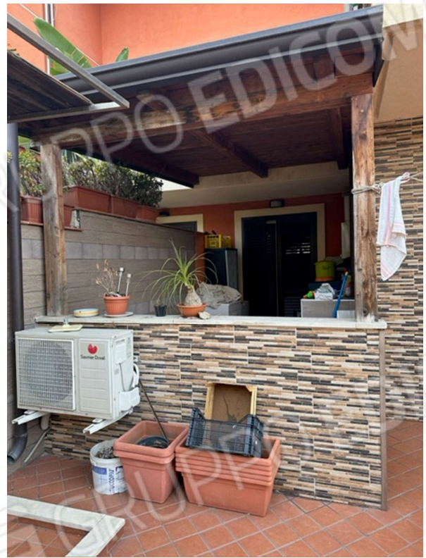
FOTO 12_ terrazzo piano terra tettoia non in regola
