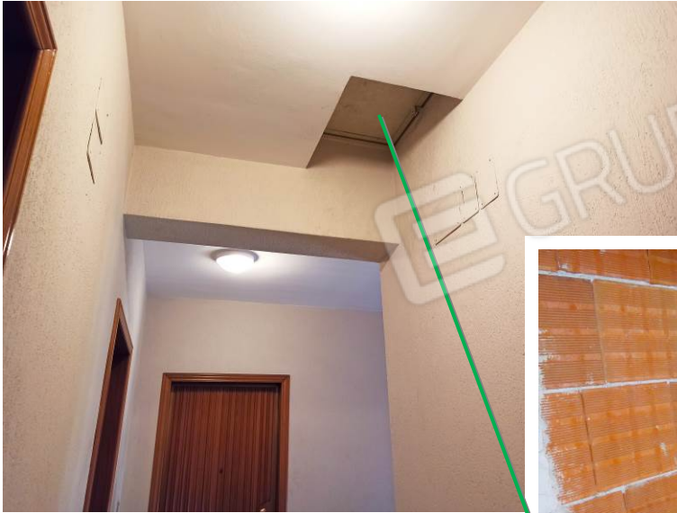
Foto n. 17 – Botola di accesso (dal pianerottolo del corpo scala comune) al locale sottotetto soprastante il bene I1.
