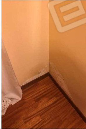
-Foto 5 (particolare umidità muro)
