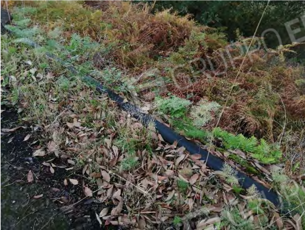
FO-23 TUBAZIONE PRINCIPALE DEL SISTEMA IRRIGUO IN DISUSO
