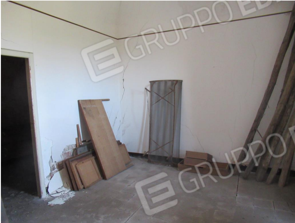
Foto n° 13 – Ulteriori pareti ammalorate –
