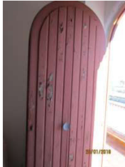
Foto n° 20 - Particolari che evidenziano lo stato di ammaloramento di alcune parti dell'immobile: pensilina, umido al pavimento in cucina, infisso, portoncino d'ingresso.
