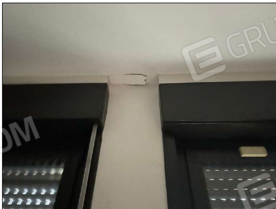
1.16. Particolare del degrado del solaio in corrispondenza della Camera 1.
