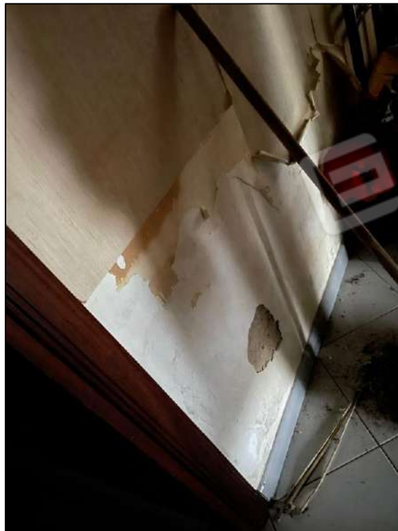
1.14. Particolare del degrado sulla parete del corridoio in corrispondenza dei bagni.
