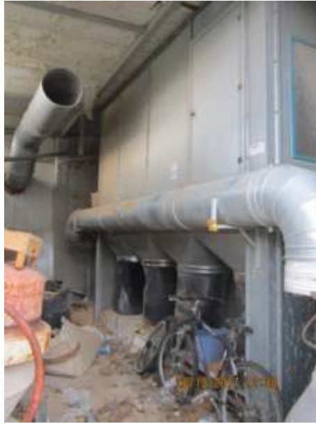
Foto n° 11 Tubazioni finali e contenitori delle polveri di risulta della lavorazione del legno
