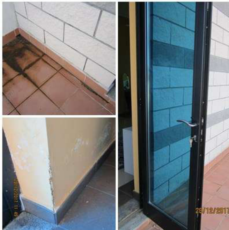
Foto n° 28 Zone di umido nella terrazza del corpo ad ovest e particolare dell'infisso
