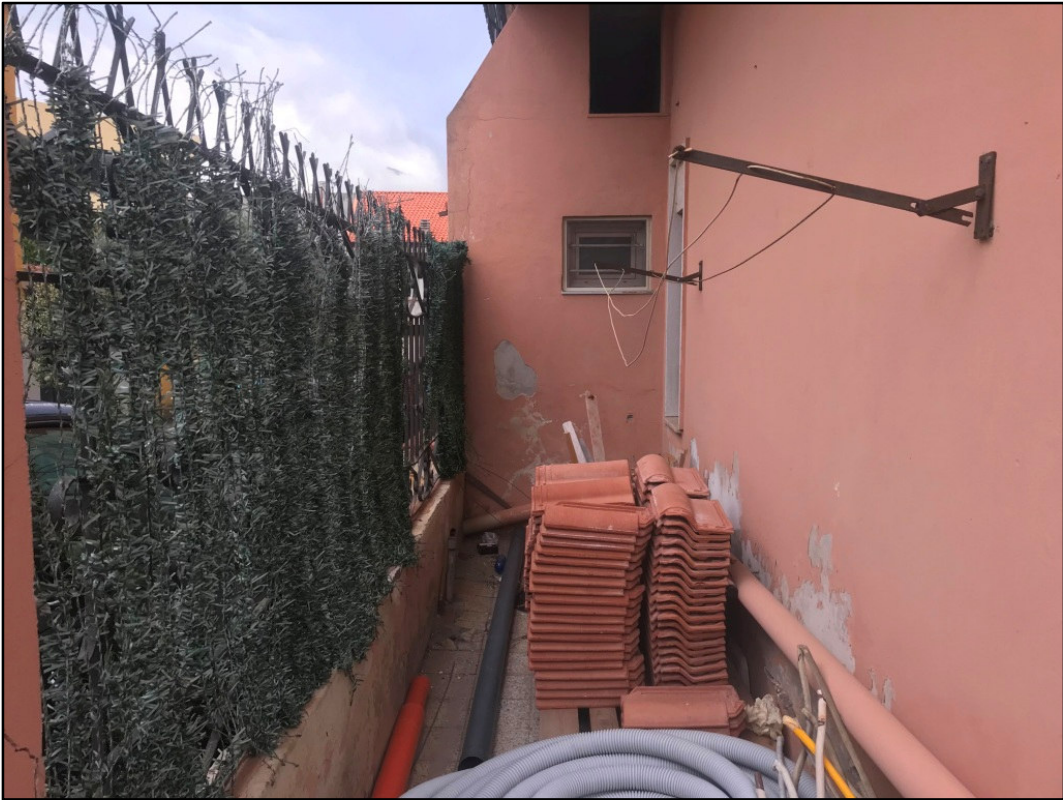
Foto 6 – Inquadratura della parte di veranda lato est. Frontalmente, è visibile la parte in ampliamento, costruita in abuso, da demolire.
